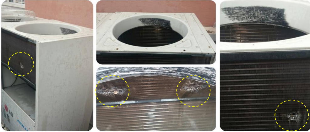
폭설로 인한 실외기 열교환기 파손
